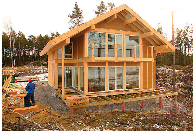
TIMBECO post-tala- ja ThermoLogi konstruktsiooniga maja Roots. Hoone õhutihedus on testide järgi 0,58 l/s.
