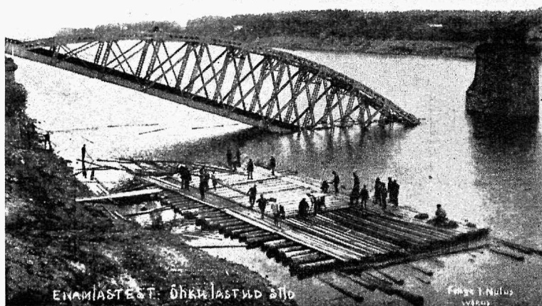
Enamlaste poolt purustatud Pihkva raudteesild. Meie remontrongid asuvad silla parandamisele.
