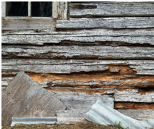
MAJASIKU ( Hylotrupes bajulus ) kahjustatud hoone välisseina palgid.
