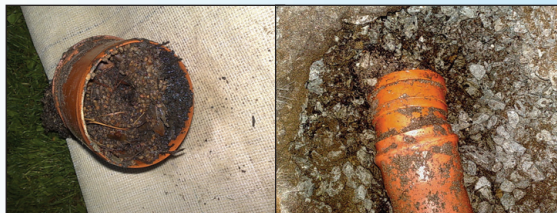
Selline näeb välja 1,5 aastat killustikus asetsenud toru, mis on ummistunud puulehtede ja okastega.
