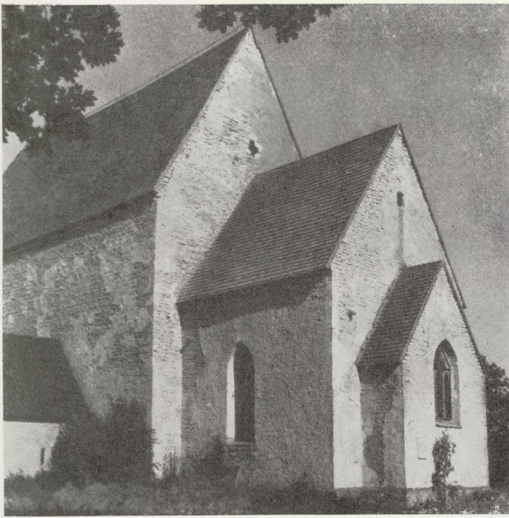
94. Üldvaade Muhu kiriku idaosale kooriruumi ja aedikutaolise lõpmikuga (idaakna alumine osa kinni müüritud).
