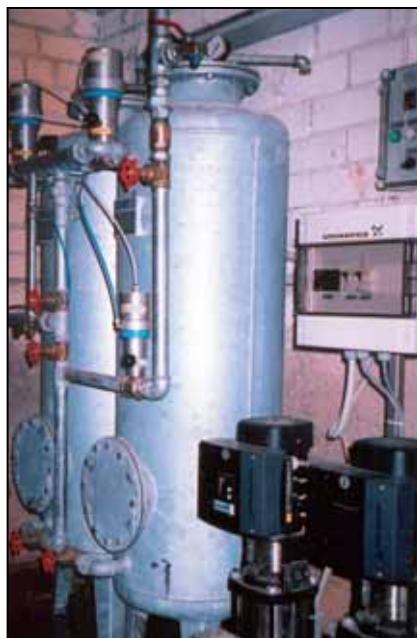
KÕO JOOGIVEEPUHASTI TÄISAUTOMAATNE PAARISSURVEFILTER 402 PRA JA RÕHUTÕSTESEADE Grundfos Hydro-MultiE 2 CRE 5-8
