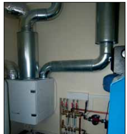
VENTILATSIOONISEADE ERAMU KATLARUUMIS
