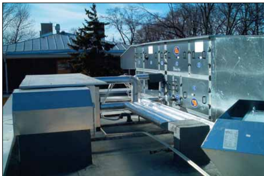
KATUSEL PAIKNEVAD VENTILATSIOONISEADMED
