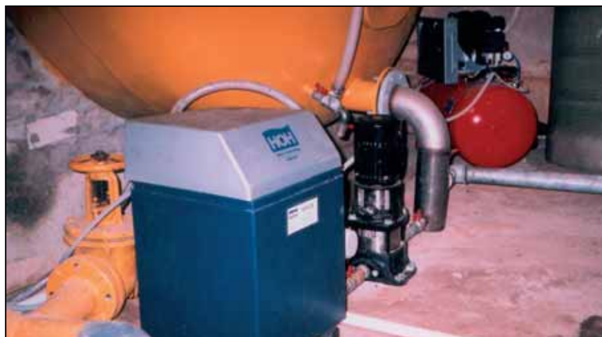
PÖÖRDOSMOOSISEADE HOH RO-2020, MEMBRAANMOODULITE LÄBIPESUSEADE CIP JA PERMEAADIMAHUTIPUMPLA KÕO VEEPUHASTUSJAAMAS
