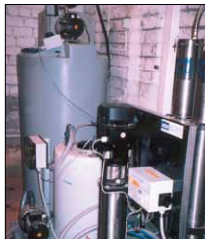
VEEPEHMENDI, PÖÖRDOSMOOSISEADME TOITEPUMP, PUHTAVEE (SEGAMIS-) MAHUTI JA PAARISSURVEFILTRI ÕHUSTUSKOMPRESSOR KÕO VEEPUHASTUSJAAMAS
