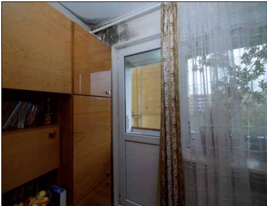
PANEELMAJA ÜLEMISE KORRUSE VÄLISNURK – ILMNE SOOJUSTAMATUSE PROBLEEM
