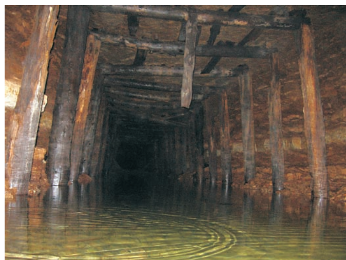
Pildil: Kõdunenud toestikuga strekk kaevanduses nr 2. Pildistatud 10. mail 2006. Samal päeval tehtud vaatluse käigus leiti Kukruse kaevanduse põhjaosas hulk lokaalseid varinguid. Kõik varinguaugud olid täidetud.
