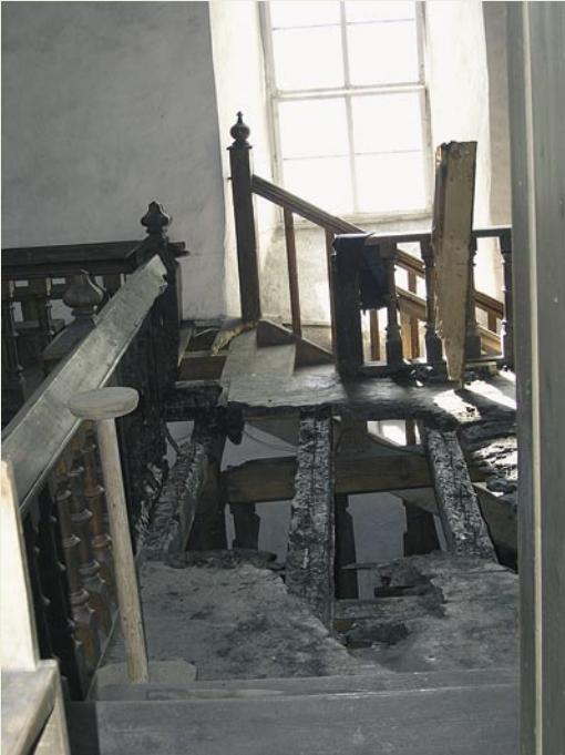
66. Vigased elektriseadmed, millest võib alguse saada laastav tulekahju. Foto M. Loit
