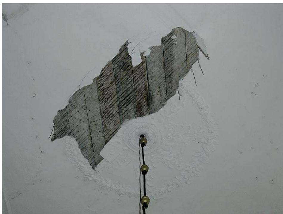
23. Läbisajust rikutud puitlagi. Foto K. Tooming
