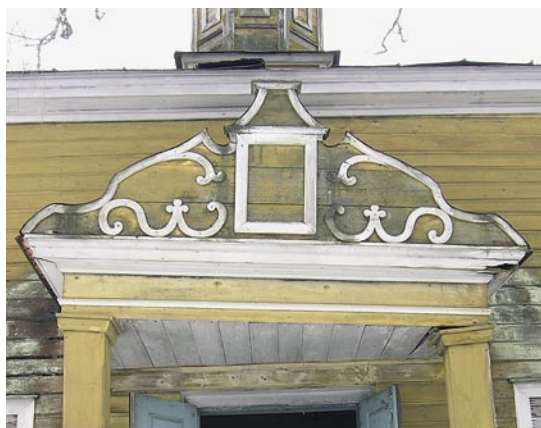
17. Kahjustatud, kuid restaureeritav puitdekoor. Foto K. Tooming
