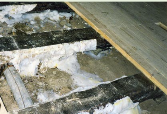
25. Õhkvahega laudpõranda alla sokli tuulutussavade puudumise või nende suletuse tõttu tekkinud mädanikseened. Foto Ü. Puustak
