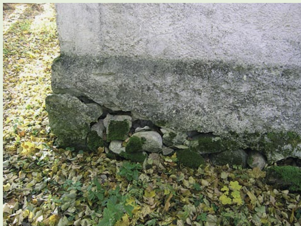
31. Kahjustunud sokkel. Foto K. Tooming
