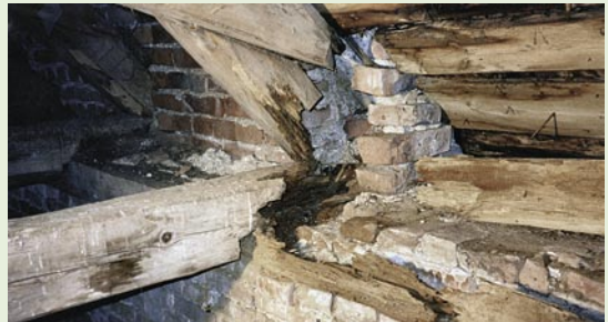
5. Katuse kandekonstruktsioonide seenkahjustused räästapiirkonnas. Foto Ü. Puustak
