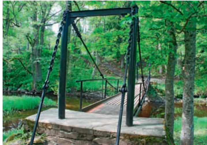
Pidev hooldus tagab sillale ohutu ja esteetilise juurdepääsu. Sula- ja sadeveed on muutnud pääsu sillale ohtlikuks. Suuremate pinnasetööde jaoks on vajalik projekt. Foto Elle Valtna
