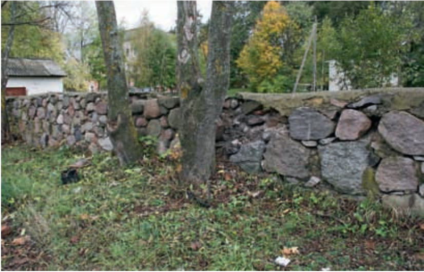
Korrapärase hooldusega (võsa eemaldamise ja niitmise) saab vältida probleemi, mida võivad põhjustavad müüridele liiga lähedal kasvavad puud. Hästi on näha, et kohtades, kus puud kasvavad müürile liiga lähedal, on müür hakanud lagunema. Foto Nele Nutt
