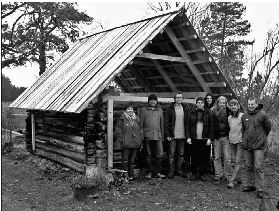
Suveköök 2008. aastal: algsete palkseinte jäänused on toetatud. Hoone katmiseks on valmistatud uus 6 x 6 tollistest prussidest sõrestik ning see laudkatusega kaetud. Hoone tervik on osaliselt taastatud, puuduvad palkviilud.
