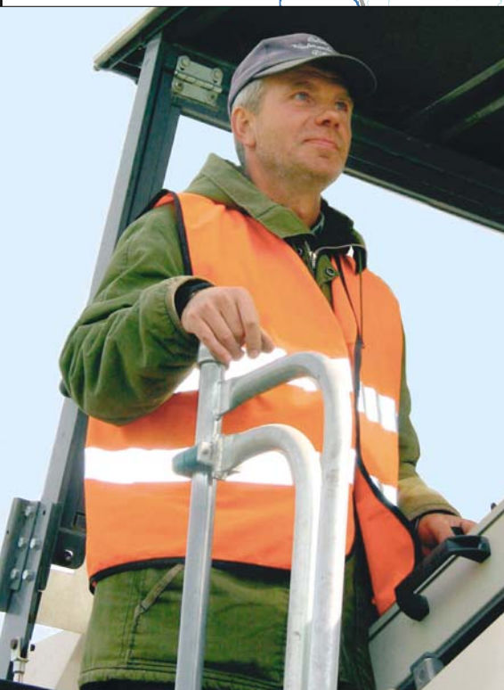
Aivar Girin (Teede REV-2) juhib teefreesi ISPA – VIA BAL- TICA II remondi- lõigul Tallinna – Pärnu maanteel 2003. aasta sügisel. Foto: E. Vahter
