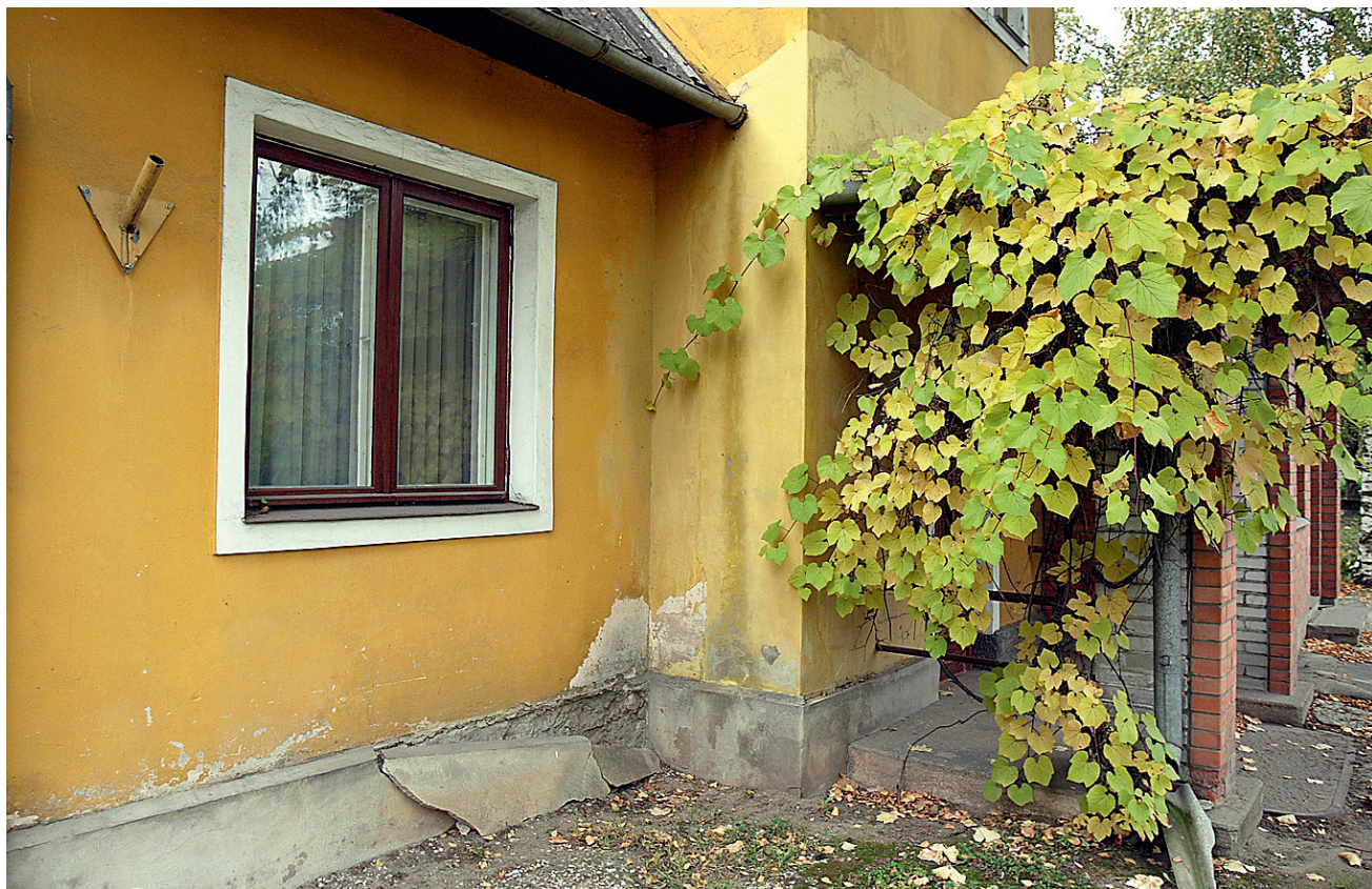
► Lekkiv vihmaveetoru rikub kiirelt värvi ja murendab krohvi.
