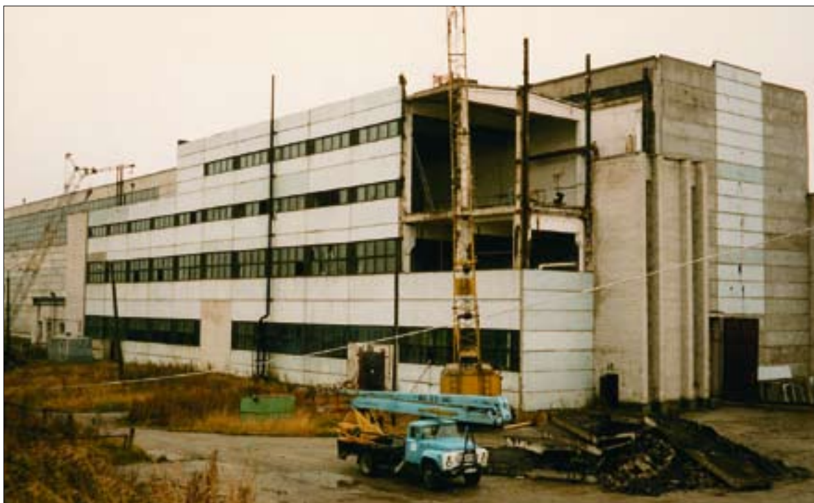
Peahoone 1996 aastal. Alustatud on külgehitise osalist lammutamist ja selle allesjääva osa ümberehitust AS A.L.A.R.A. töö- ja kontoriruumideks.
