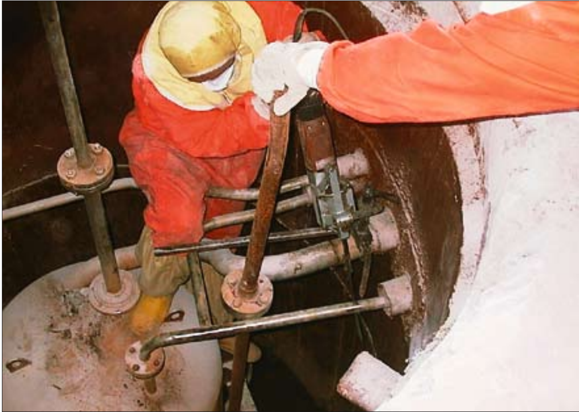
Pärast mahutisetete tahkestamist alustati radioaktiivsete vedeljäätmete hoidla seadmete demonteerimist. Saaste leviku vältimiseks kasutati saastunud torustike tükeldamiseks spetsiaalseid aeglasekäigulisi elektrisaage.
