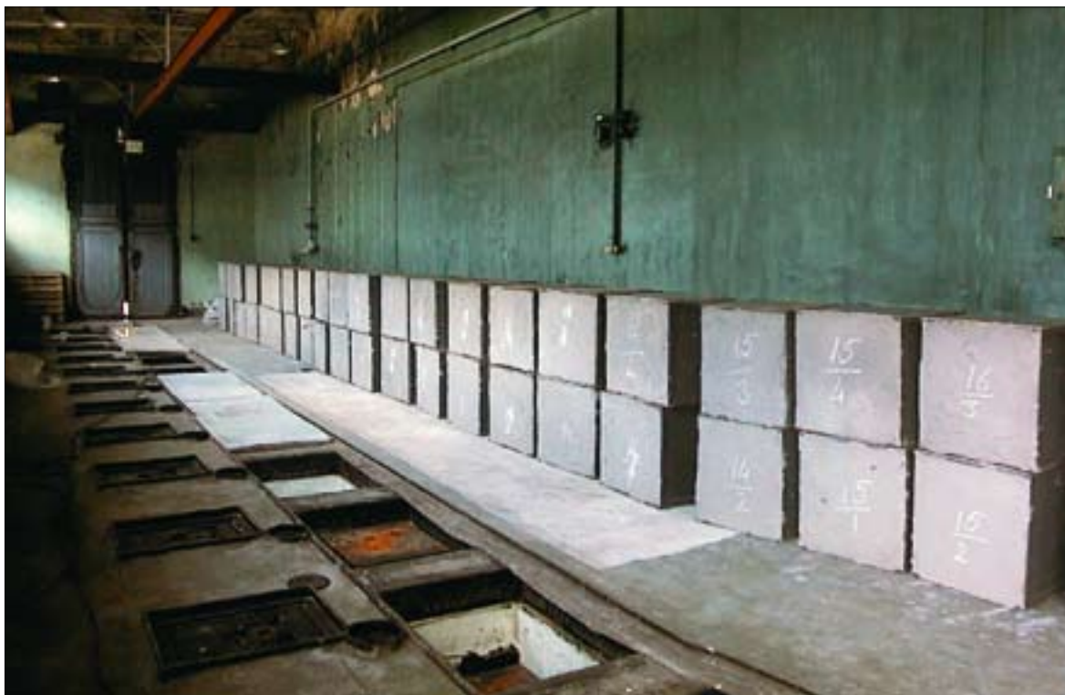
Vaade ventilatsioonihooone sisemuses. Tagaseina ääres on väljaveo ootel ladustatud nõrgalt saastunud HEPA filtrid.
