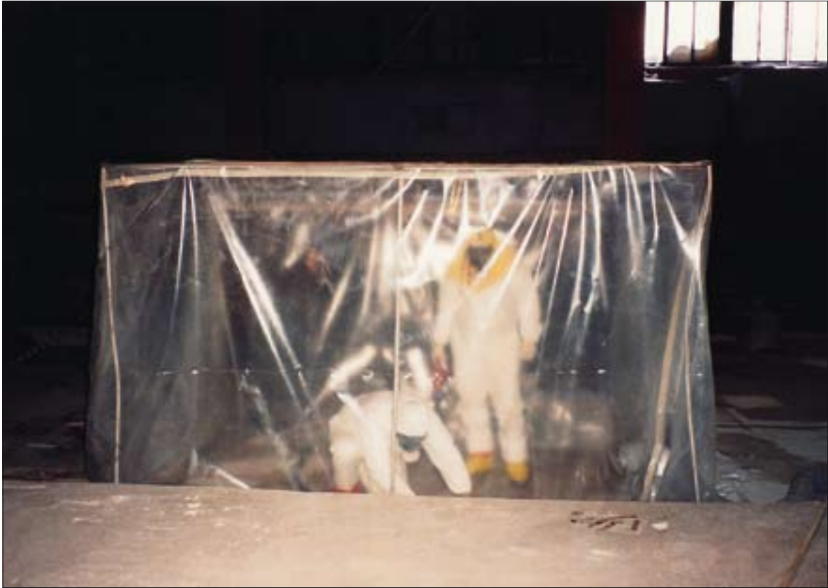
Peahoone mõnedes ruumides leidunud radioaktiivne saaste on praeguseks hetkeks valdavalt eemaldatud. Desaktivatsioonitöödel kasutatud teisaldatav kilehoone.
