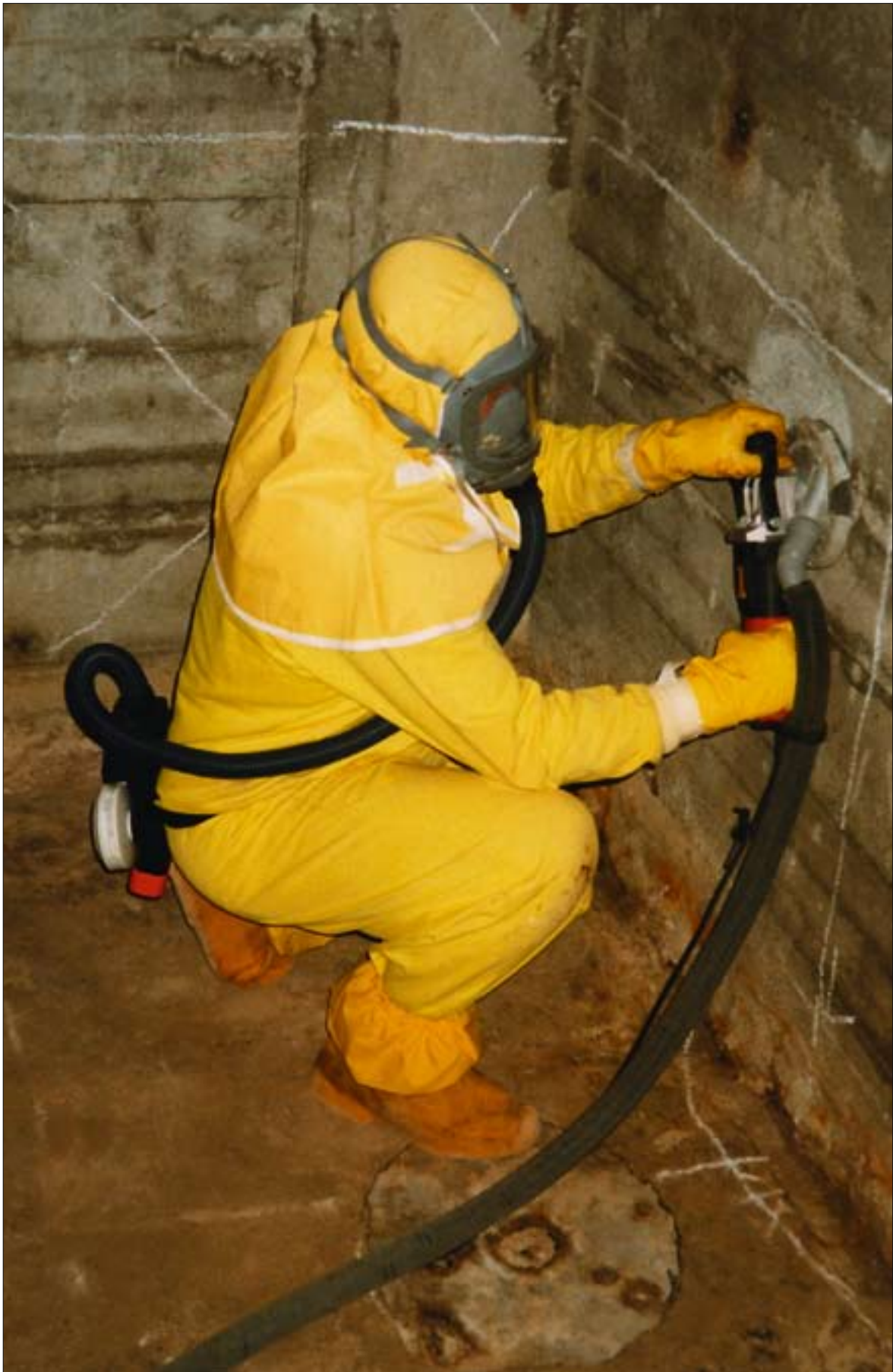
Pärast jäätmete eemaldamist puhastati radioaktiivsete tahkete jäätmete hoidla seinad radioaktiivsest saastest. Selleks kasutati teemantkettaga varustatud käsilihvimismasinat. Tekkiv tolmeti tööstusliku tolmuimeja abil kogumismahutisse.
