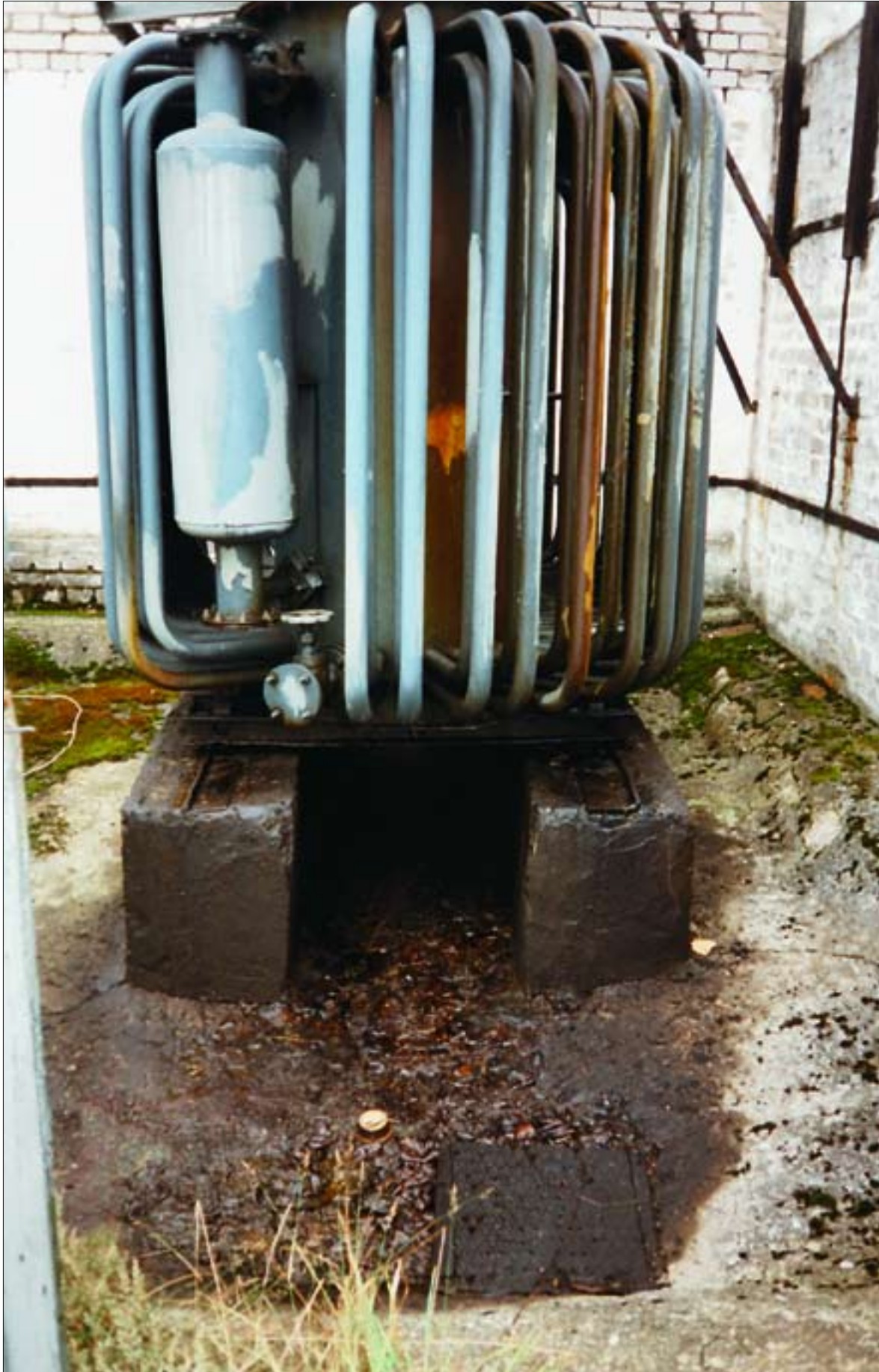
Trafoõli lekkest põhjustatud reostus Paldiski tuumaallveelaevnike õppekeskuse tuumaobjekti territooriumil selle ülevõtmise ajal.
