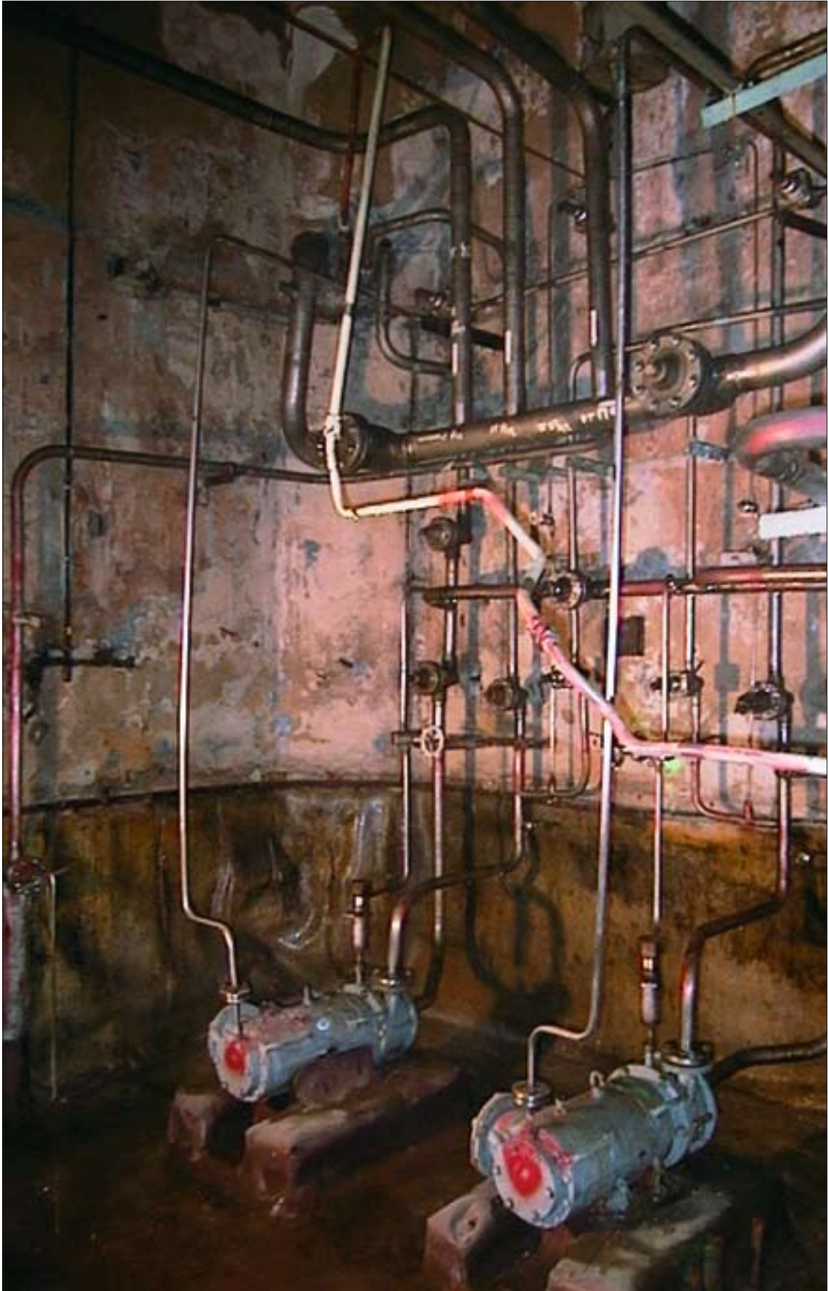
Radioaktiivsete vedeljäätmete töötlemiskompleksi torustikud.
