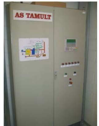
Katlamaja kontrollritega automaatuhtimise kilp
