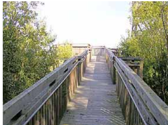
Hea näide kaldteest, mis on piisavalt lai ja tugevate piiretega mõlemal pool. Kindla vahemaa tagant on kaldteel laued puhkekohad.
