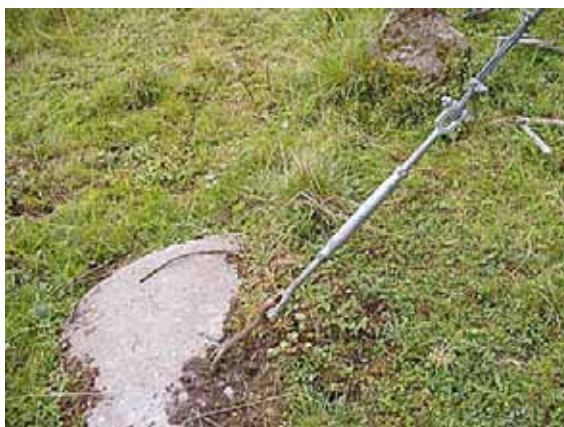
Reguleeritav tross muudab torni stabiilsemaks.
