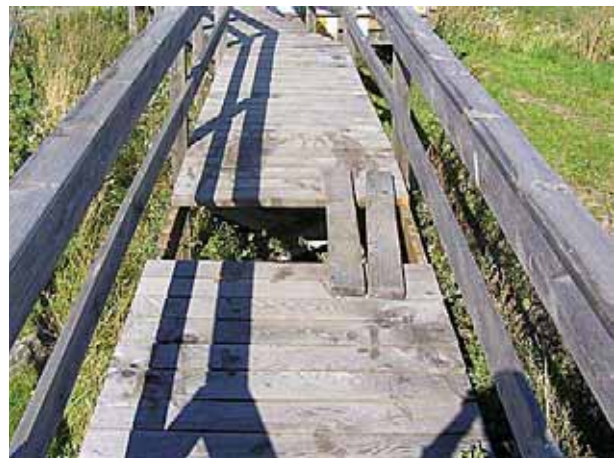
Hästidiseinitud kaldtee, mille vandaalid on purustanud. On vaja kohest remonti, et muuta tee kasutatavaks ka ratas- ja inimestele.
