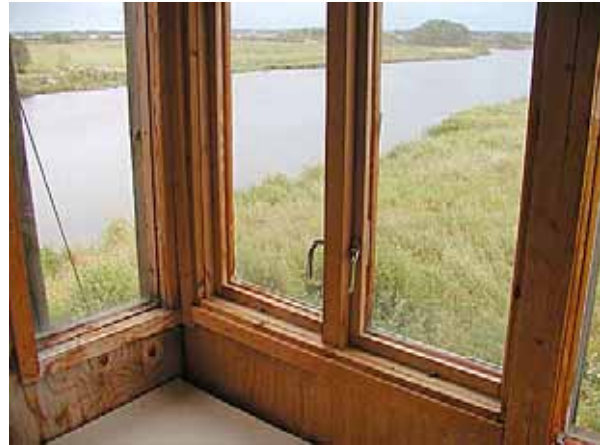
Kütmata ruumides tekitab probleeme akendelt nõrguv kondensaatvesi, mis on valgunud mööda seinu alla.
