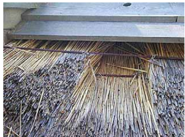
Siin on pardid kiskunud katuseroogu. Võrkmaterjalist kaitsekate aitab taolisi kahjustusi ära hoida.
