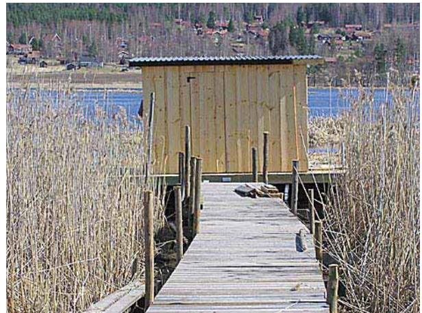
Lai käigusild viib ehitatava vaatluskohani. Ülespanemist ootavad tugevad piirded ja sirmid, mis varjavad silda vees olevate lindude eest.
