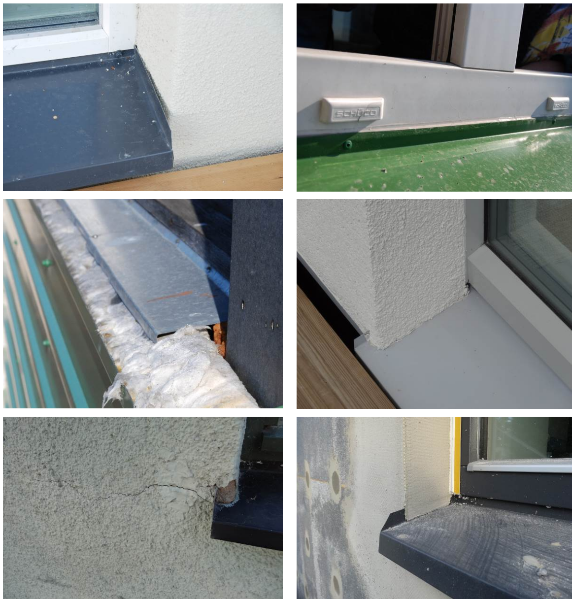
Joonis 2.51 Tüüpilised vead aknapleki paigaldamisel: aknaplekk ei ulatu otstest fassaadikatte alla (ülal vasakul) ega akna aknaraami alla (ülal paremal); aknaplekk ei ulatu piisavalt üle seina või ei ulatu üldse seinale; (keskel vasakul); krohv ulatub aknapleki ja seina liitumiskohas on praod, kust vesi saab seina valguda (ülal ja all vasakul). Krohvimise ajal on aknaplekk määrdunud (all paremal).
