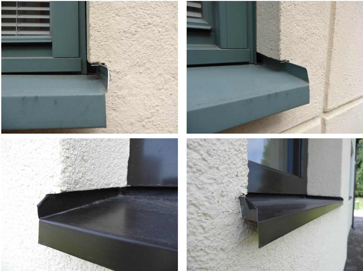
Joonis 2.52 Aknaplekk peab ulatuma fassaadikatte alla külgedelt ja aknaga liitumisel aknaraami alla. Alumistel fotodel on aknapleki kalle liiga väike.
