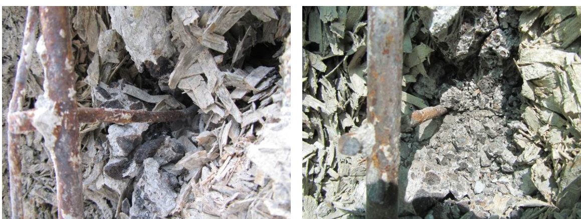
Joonis 2.63 Seeria I-464A välisseinapaneeli väliskooritud kinnihoidvad sidemed on 45 aastaga hakanud juba korrodeeruma.
