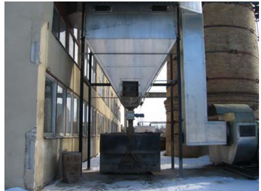
B. Konteiner tuhapunkri all. Punkri ja konteineri vahel on näha sektorlukk
