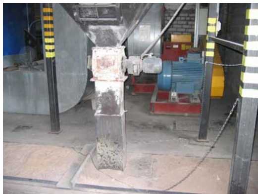
Joonis 8.37. Multitsükloni alus ja kanali betoonkaas, foto Ü.Kask
