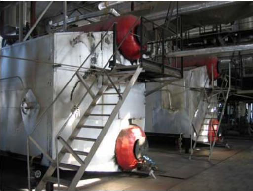
Joonis 8.21. DE tüüpi katlad Võrusoo katlamajas, vaade tagant, foto Ü.Kask
