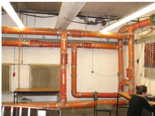
Joonis 9 Ventilatsiooni labor
