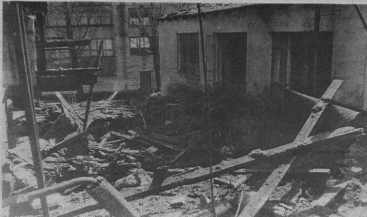
Kahe kõrgema hoone vahel asuvas boileriruumis toimunud plahvatus purustas ehitise põhjalikult. Sellel pildil on näha katusesse tekkinud auk.
