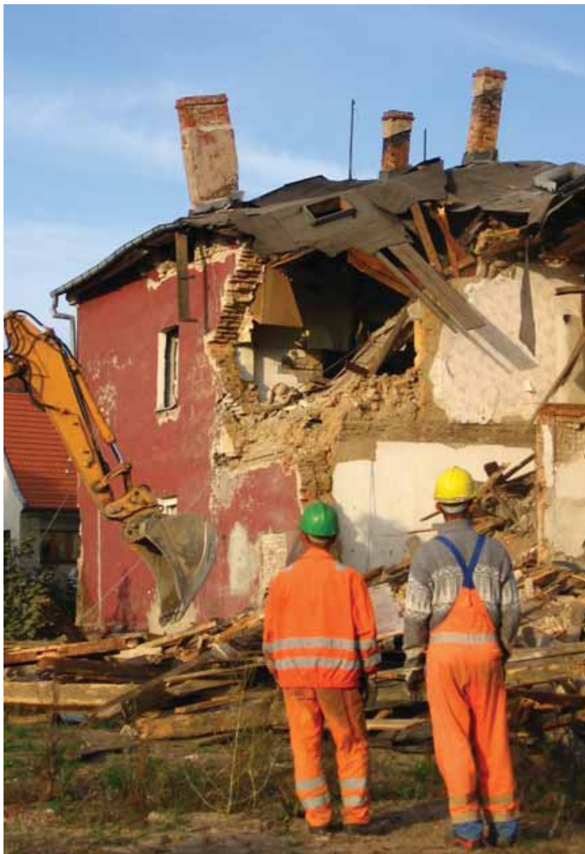
Asbestimäärus seab tööandjale kohustuse enne ehitise lammutamist, rekonstrueerimist, remonti või hooldust veenduda, kas see sisaldab asbesti või ei sisalda. Foto: Dreamstime
