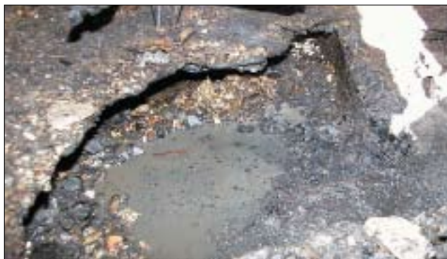
Foto 4. Lokaalsed kahjustused elutoal põrandal.
