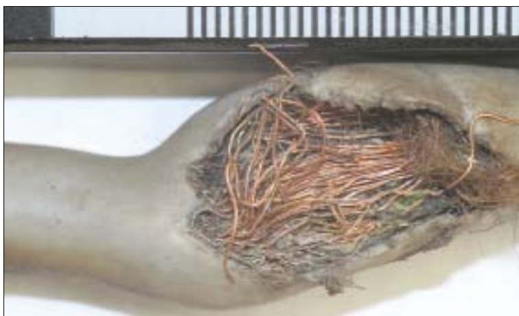
Foto 17. Katkenud juhtmekiud, mille sädelemine põhjustas turbatolmu plahvatuse.
