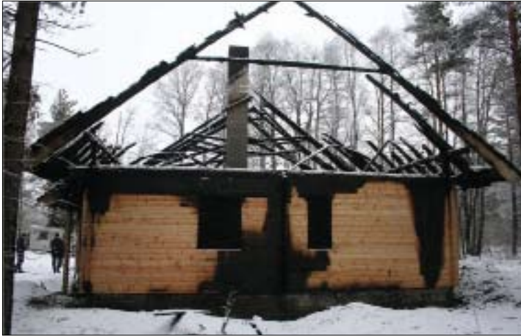
Foto 8. Allakukkunud põleva materjali põhjustatud põlemisjäljed hoone välisseinal.
