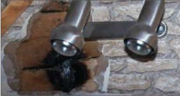
Foto 18. 60-vatise võimsusega hõõglambi tekitatud termiline kahjustus.
