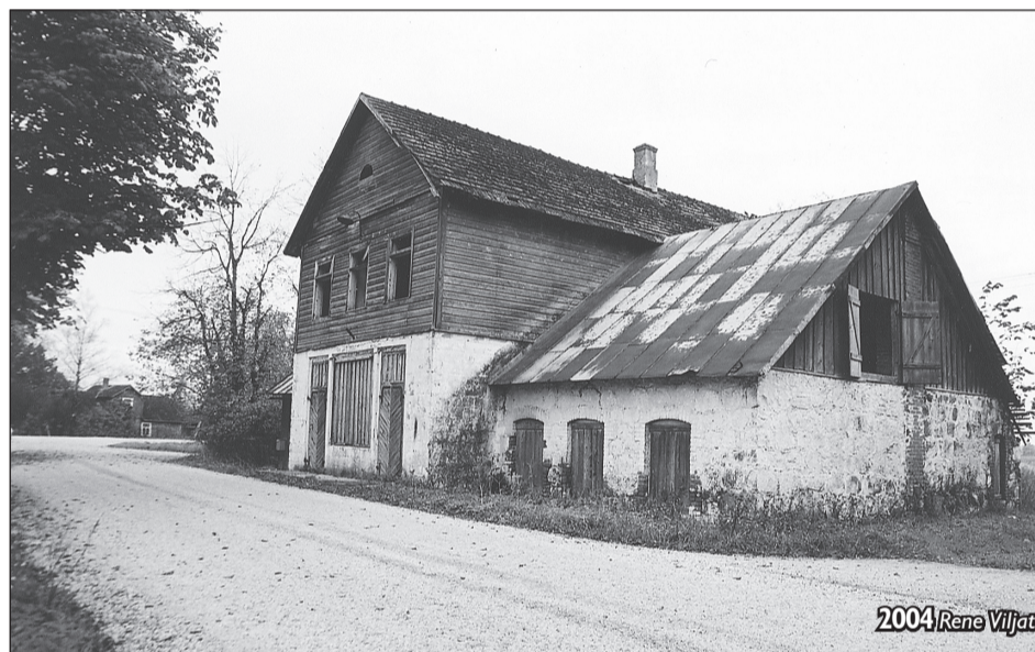
Vana meierei hoone tegutses nõukogude korra ajal koorejaamana. Tegevus lõpetati selles majas 1973. aastal piima vastuvõtupunktina ja pärast seda on hoone lagununud. Kuna katus laseb läbi, ei ole midagi imestada, kui ükskord kõik kokku kukub. Osaliselt on säilinud algseid tahveluksi.
