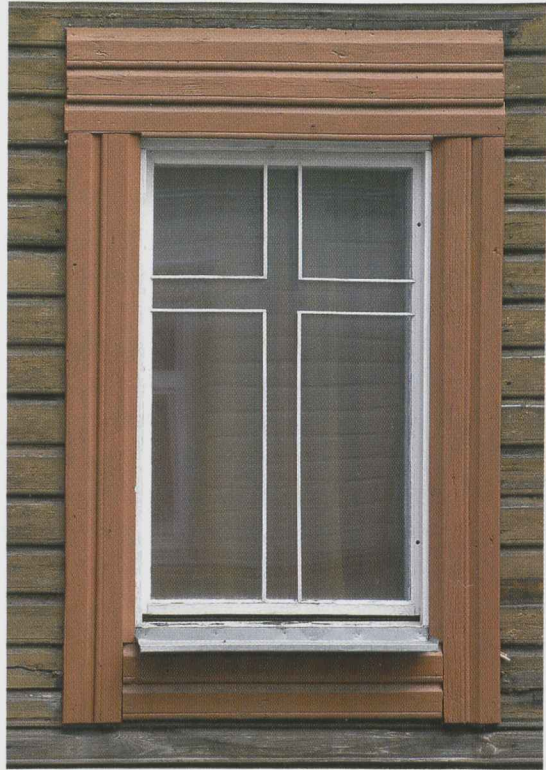
Akendevahetuse käigus paigaldatud lihtsustatud piirdelauad rikuvad ehitise ilmet ja devalveerivad hoone väärtust (ka rahalist)
