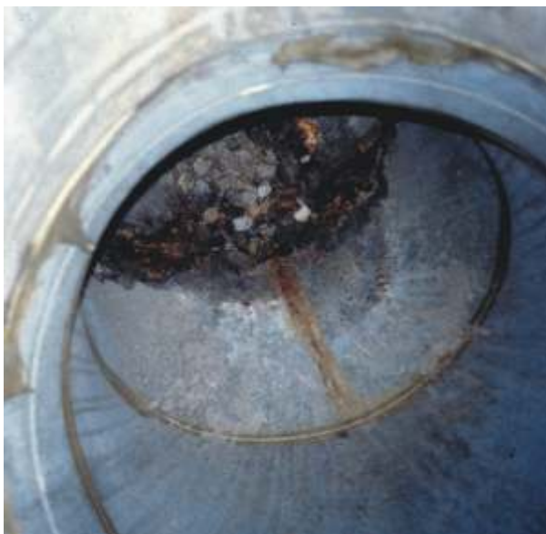
Joonis 41. Ventilatsioonivavad on tihti täis tolmu ja seeneseid, mis just ei paranda ruumis valitsevat kliimat.
