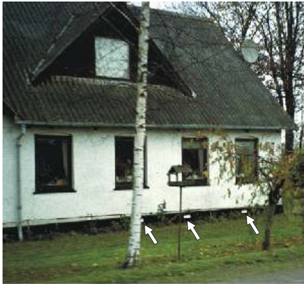
Joonis 54. Kui maja põranda all on hästitöötav ventilatsioon, ei tohiks seda talvel sulgeda. See aitab vältida kondensatsioonivee tekkimist suvel.
