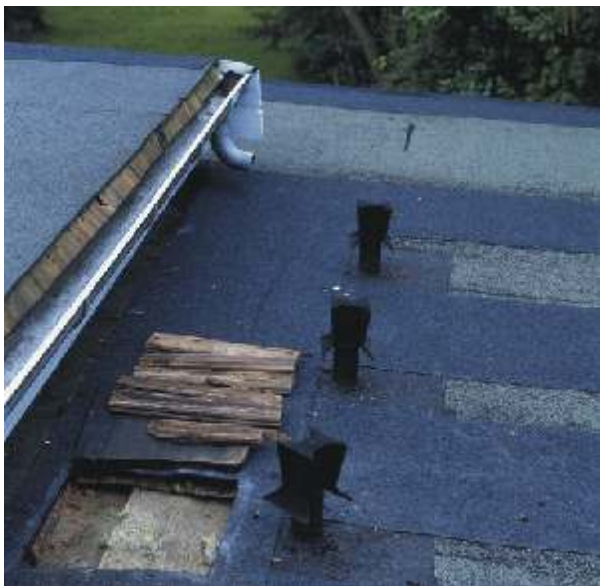
Joonis 38. Katusesse tehtud avad halvendavad olukorda, kuna ruumidest tulev niiske õhk ning katuse pinnal puhuv tuul tekitavad katusealuses ruumis vaakumi ja vee kondenseerumise tulemusel saavad seal arenema hakata hallitusseened.
