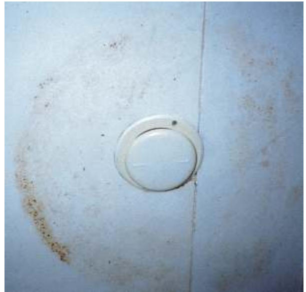
Joonis 42. Ventilatsioonivava ümbruses on läbijooks või toimub vee kondenseerumine ruumiõhust ning kasvama on hakanud hallitusseened.
