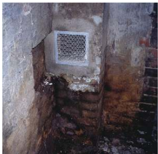
Joonis 55. Keldrit saab õhutada vana korstna kaudu, mida enam ei kasutata.
