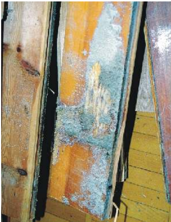
Joonis 17. Konstruktsioonide avamine ja hoolikas kuivatamine on ulatusliku niiskumise korral väga oluline. Vastasel juhul hakkavad konstruktsioonide puitosadel juba mõne päeva möödudes arenema hallitusseened.
