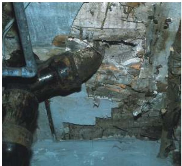
Joonis 45. Tilkuvad veetorud panevad aluse ulatuslikule seenkahjustusele.
