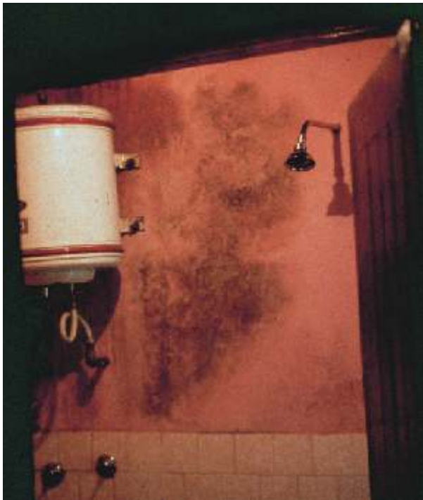
Joonis 44. Vannitoad peaksid olema hästi õhutatud, et vältida hallitusseente kasvu seintel. Antud juhul oleks seina hallitamist saanud ära hoida, kui kahlhelplaadid katnuks kogu seina.
