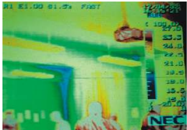
Joonis 53. Infrapunakiirgust saab kasutada hoone külmasildade kindlaks tegemiseks. Pildil on külmasild näha sinisena.
