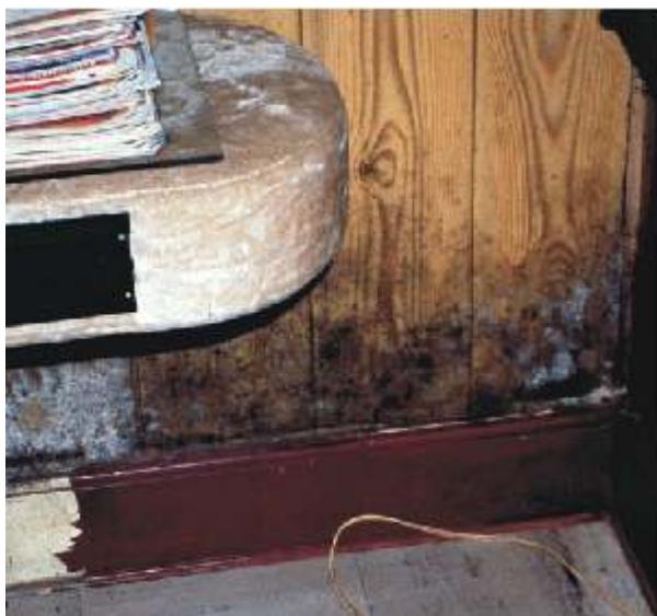
Joonis 20. Niiskunud puitu ja puidust valmistatud pabertapeeti kahjustavad kergesti hallitusseened.
