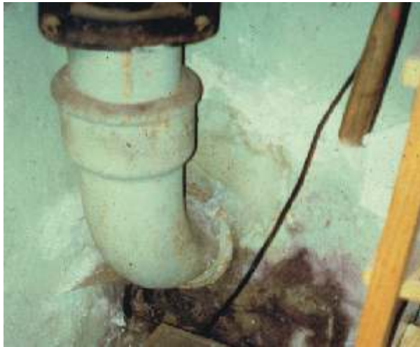
Joonis 51. Äravoolutoru on veidi murdunud, kuna pinnas on vajunud ning kõdunemisprotsess ja seened tungivad ruumidesse.
