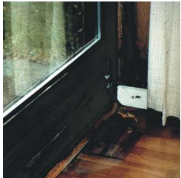
Joonis 1. Ruumide tihendamine võib kergesti tuua kaasa õhuniiskuse suurenemise ruumis ja vee kondenseerumisest tulenevad probleemid. Kui ruumis puudub ventilatsioon, ilmuvad seintele ja põrandale peagi tumedad hallituslaigud.
