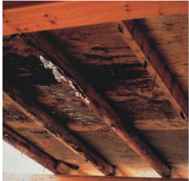
Joonis 39. Hoonele rajatud viilkatus ei ole veekindel ning ventilatsioon ei toimi, seetõttu on taladele ilmunud kondensatsioonivesi ja hallitusseened.
