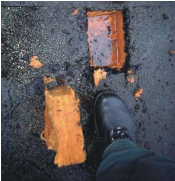
Joonis 31. Katuse, mis koosneb betoonplaatidest, kivivillast ja asfaldikihist. Vesi tungib kergesti katuse alla, soodustades seente ja bakterite kasvu. Päikese käes kuumenedes surub vee aurustumisel tekkiv rõhk saastunud vett edasi katuse all paiknevasse ruumi.
