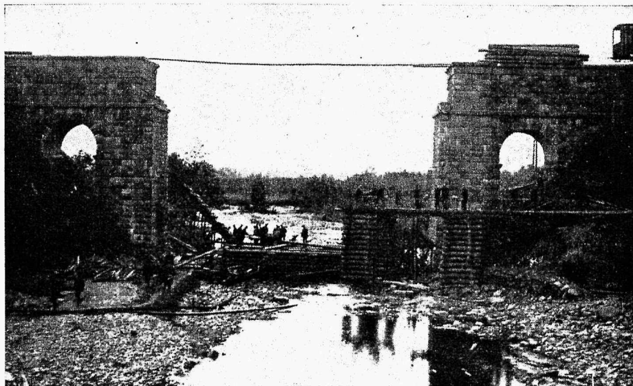
Landeswehri poolt purustatud Arraši sild, Ramotski jaama lähedal, mille parandamine takistas 3 päeva meie soomusrongide edasilükumist Riia sihis.
