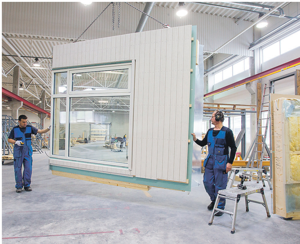
TEHASES toodetud maja ehitus on paremini kontrollitud ning puudub ilmategur, st et hoone ei saa ehituse käigus külma- ega vihmakahjustusi. FOTO: RAUL MEE
