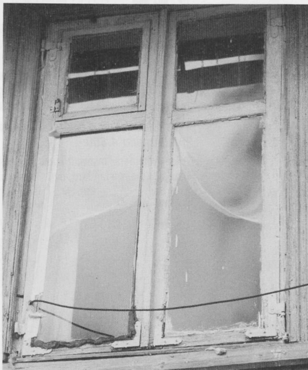
Ett fönster i mycket dåligt skick provisoriskt lagat med tejp och någon massa. Rakt igenom karmen har en antennsladd dragits. En praktiskt detalj är det öppningsbara väringsfönstret.
