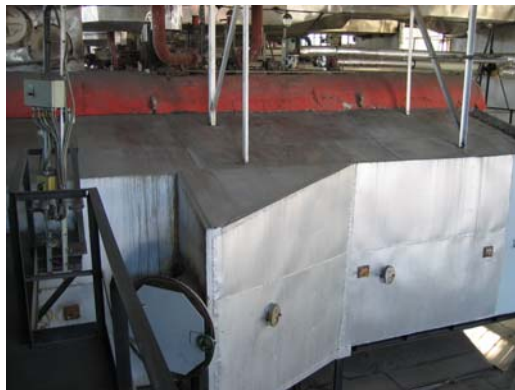
Рис. 8.23. Место установки дополнительной мазутной горелки (фото Ю. Каськ)
