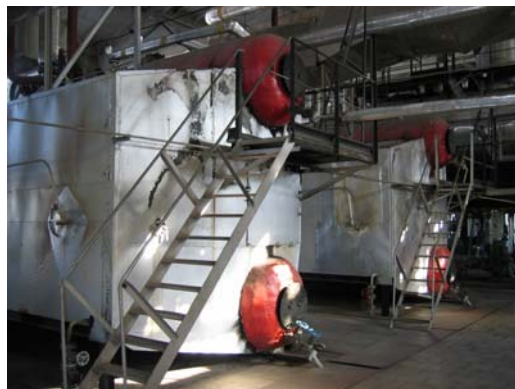
Рис. 8.21. Котлы типа ДЕ в котельной Võrusoo , вид с тыла (фото Ю. Каськ)
