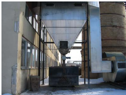
В. Контейнер под золовым бункером. Между бункером и контейнером виден секторный затвор
