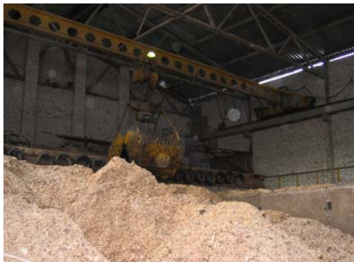
Рис. 8.18. Погрузка топлива грейфером на складе котельной Aardla (фото Ю. Каськ)
