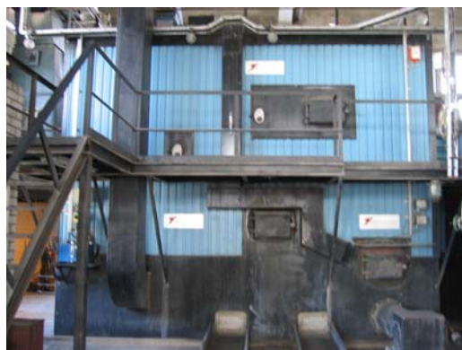
Рис. 8.22. Предтопок, установленная в котельную Võrusoo (фото Ю. Каськ)
