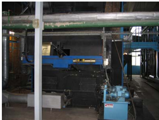
Рис. 8.26. Фронт реконструированного котла типа ДКВР (фото Ю. Касък)
