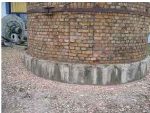
Рис. 8.12. Разрушение основания дымовой трубы (фото Ю. Каськ)
