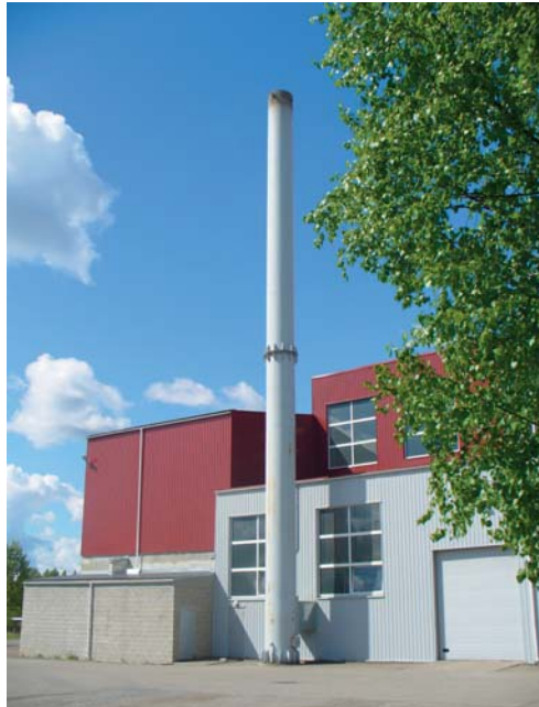
ASi Võru Soojus biokütusel töötav katlamaja
