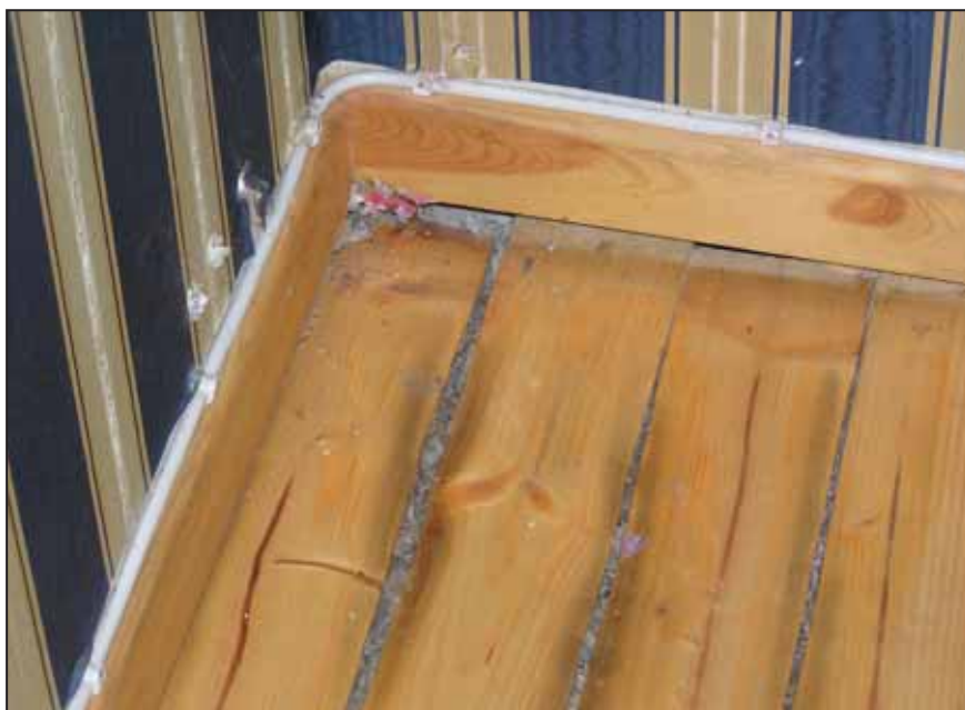
FOTO 3. PÕRANDALAUAD ON ALTPOOLT PRUUNMÄDANIKUGA TUGEVASTI KAHJUSTATUD JA PÕRAND VAJUB LÄBI
