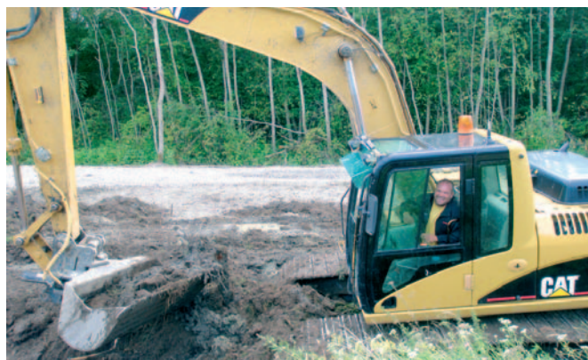
Heino Väli, TREV2 projektijuht Kuussaare ringtee ehitusel: „Ekskavaatori kabiinis on Veiko Kiis. Teigi väga head tööd. Tellija oli väga rahul.“
