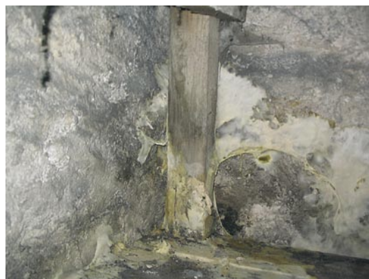
56. Повреждение грибами в древесине, расположенной у влажной каменной стены, заметное и невооруженным глазом. Фото: У. Каллауэ
