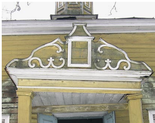
13. Поврежденный, но подлежащий реставрации деревянный декор. Фото: К. Тооминг
