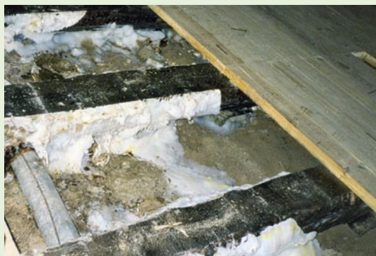
19. Грибы гнили, разросшиеся под деревянным полом из-за отсутствия или закрытия вентиляционных отверстий в цоколе. Фото: Ю. Пуустак
