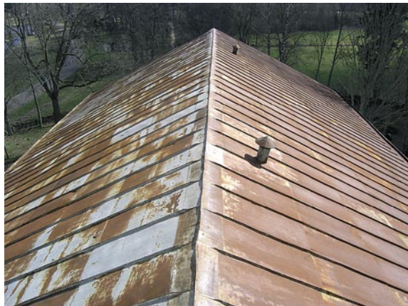
10. Жестяная крыша, нуждающаяся в уходе.
