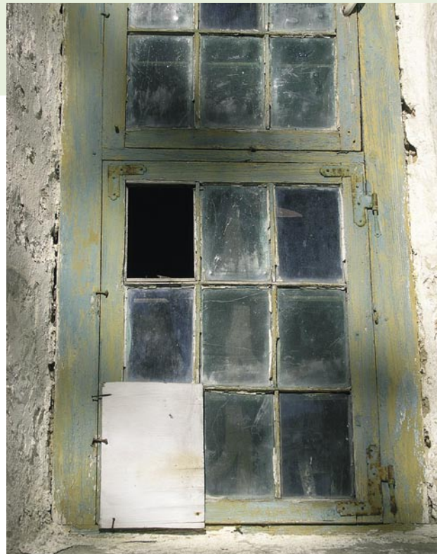
22. Разбитое оконное стекло временно заменено фанерой. Фото: К. Тооминг
