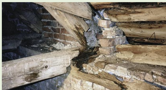
5. Повреждения грибами несущей конструкции крыши в области стрехи. Фото: Ю. Пуустак
