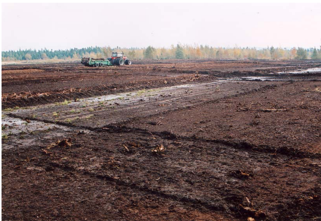
Foto 31. Jääksoo pindmise oksüdeerunud ja külmakohrutatud turbakihi eemaldamine, pinnase tasandamine ja paremate niiskustingimuste loomiseks turbavallidega väiksemateks aladeks jagamine (foto E. Karofeld).
