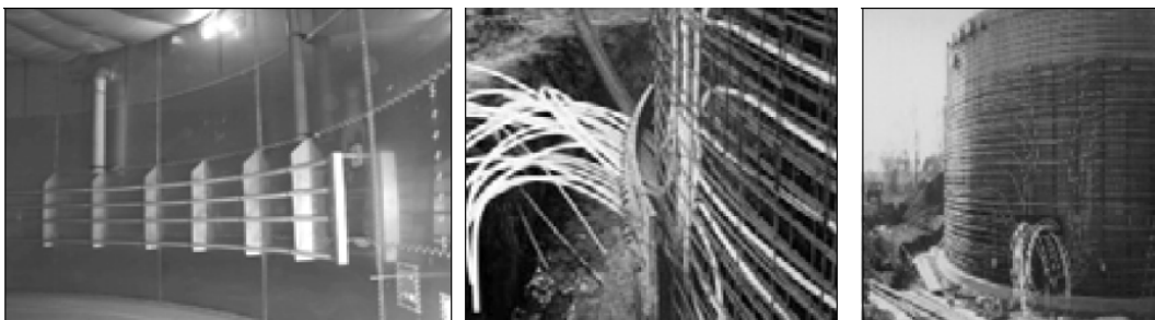
Joonis 3-35: Metallist küttestorustik (vasakul), küttestorude montaaž seinale (keskel ja paremal); foto vasak ja keskmine: Biogas Nord GmbH; parem PlanET Energietechnik.
