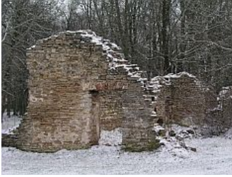
Avariilises seisundis Roosna-Alliku mõisa kasvuhoone on varisemisohhtlik ja ohustab kõrval asuva kooli õpilasi. Juba 2003. a tegi inspektor ettepaneku varemete likvideerimiseks ja muinsuskaitse lõpetamiseks. Praeguseks ei ole kaitset lõpetatud ega nõutud omanikult varemete konserveerimist.
